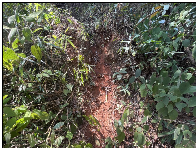
Figura 10: Escorregamento superficial. Fonte: Geoline Engenharia, 2024.
