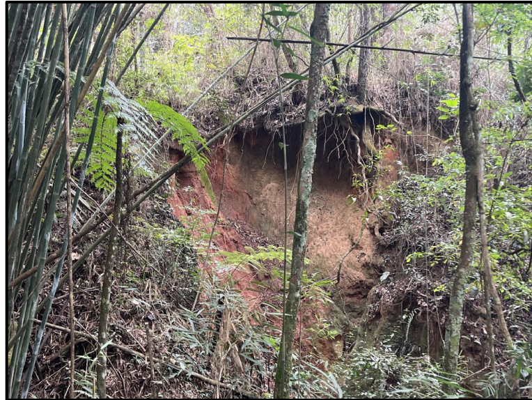
Figura 9: deslizamento planar registrado dentro dos limites da área de estudo local. Fonte: Geoline Engenharia, 2024.
