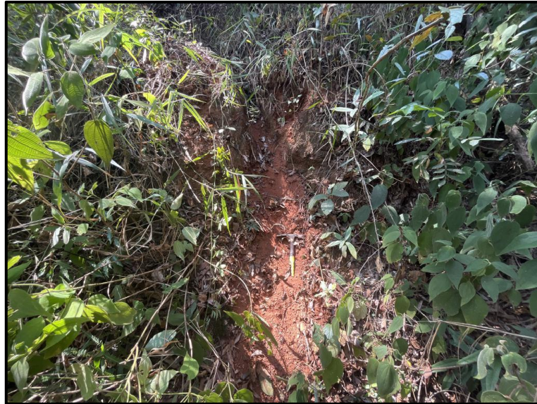
Fotografia 11: Escorregamento superficial. Fonte: Geoline Engenharia, 2024.
