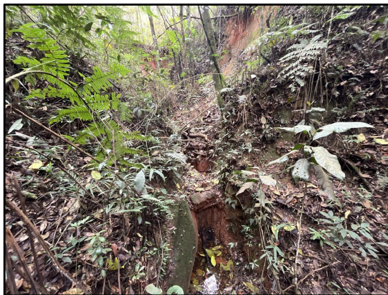
Fotografia 10: Voçoroca desenvolvida dentro da área de estudo local. Fonte: Geoline Engenharia, 2024.
